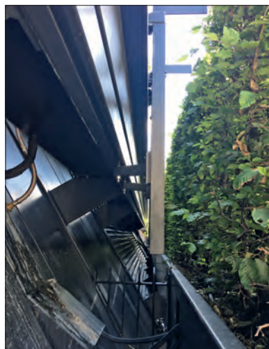
Die Technik liegt hinter den Kastenelementen verborgen.
